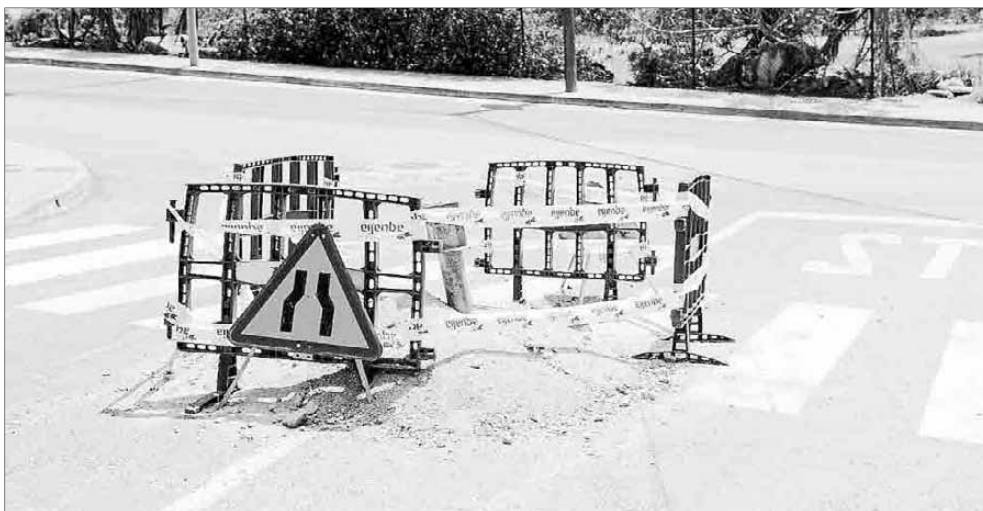
Vecinos destacan que el problema tiene ver con el aumento de la presión, que rompe las tuberías. Foto: TONI P.
